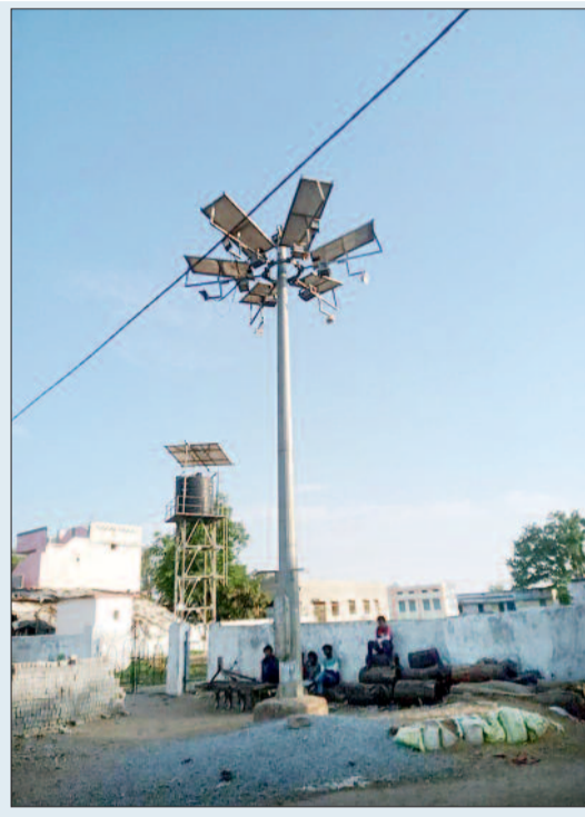
शहर सहित ग्रामीण क्षेत्रों में गली-मोहल्ले व चौक चौराहों को रोशन करने के उद्देश्य से शासन प्रशासन द्वारा लाखों रूपए खर्च कर सौर ऊर्जा स्ट्रीट लाइट लगाया गया, लेकिन देखरेख के अभाव में सौर ऊर्जा स्ट्रीट लाइट बंद व जर्जर हो चुकी है। वहीं जिला मुख्यालय से लगभग 7 किलोमीटर की दूरी पर स्थित ग्राम सिंघनपुरी में इन दिनों एक गंभीर समस्या ग्रामीणों के लिए परेशानी का कारण बनी हुई है। गांव के प्रमुख चौक चौराहों पर लगी सौर ऊर्जा स्ट्रीट लाइट पिछले चार महीनों से बंद पड़ी हुई है, जिसके चलते रात के समय पूरे क्षेत्र में अंधेरा छाया रहता है। जिससे रहवासियों को भारी कठिनाइयों का सामना करना पड़ रहा है साथ ही साथ राहगीरों भी भारी असुविधा का सामना करना पड़ रहा है। बताया जाता है कि ग्राम सिंघनपुरी के मुख्य चौक-चौराहों में लगे सौर ऊर्जा स्ट्रीट लाइट पिछले चार महीनों से बंद होने से शाम ढलते ही चौक-चौराहों में अंधेरा फैल जाता है। अंधेरे के कारण छोटी-बड़ी दुर्घटना की आशंका बनी रहती है।
